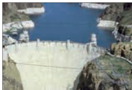
Lipiri structurale la baraje
