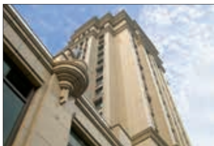
Rosturi la fațade
